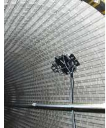
Ensayo robot en progreso en un turbogenerador (la función RIV es opcional)
