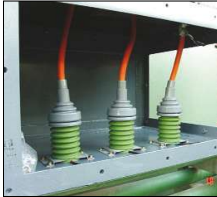
Acoplador Capacitivo Instalado
